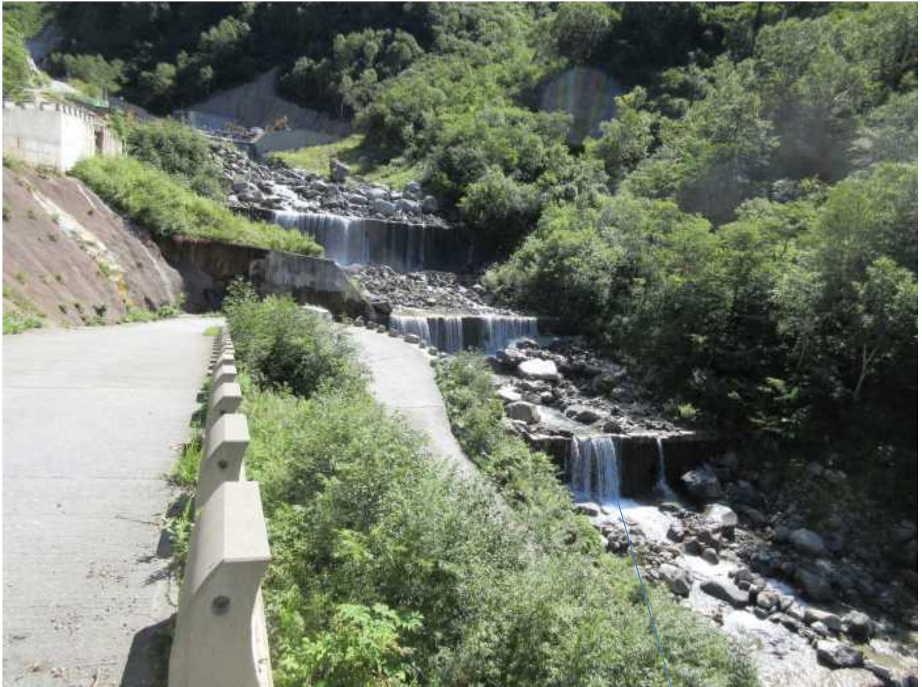
柳谷第7号堰堤
