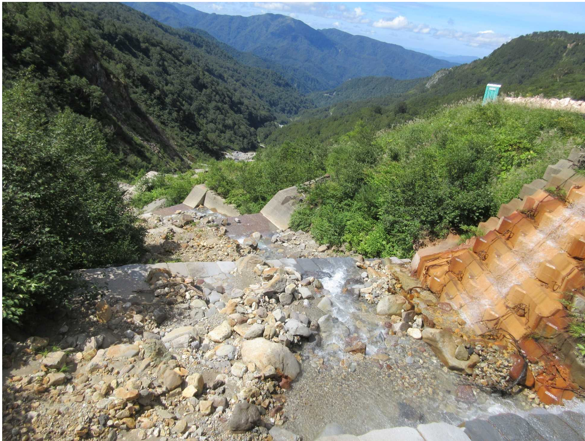
甚之助第7号堰堤 埋没付近 R1.9撮影
